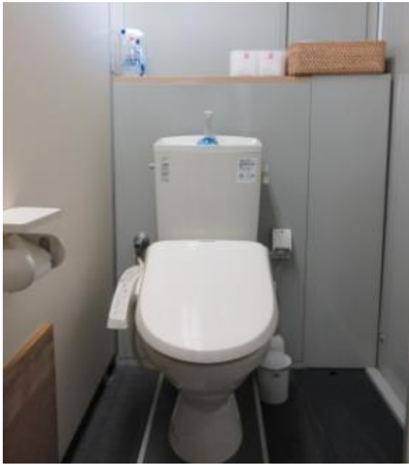
図-8 現場内に設けられた快適トイレ（洋式）
