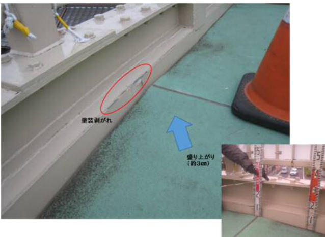
写真-3 衝突箇所直上の通路部の盛り上がり
