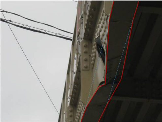
写真-2 桁の歪み状況
