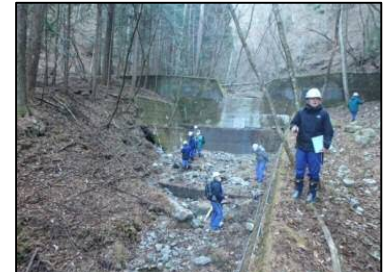
写真－4 緊急点検
