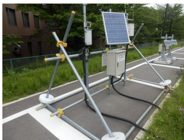
図-3 危機管理型水位計（堤防設置・水圧式）
