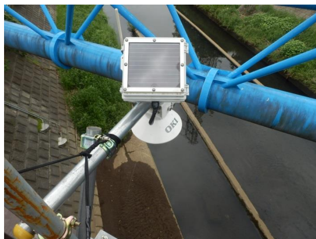
図-2 危機管理型水位計（橋梁設置・超音波式）
