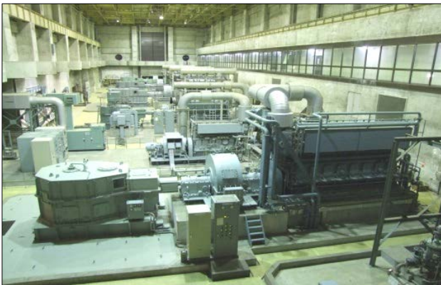
写真-1 排水機場ポンプ設備
