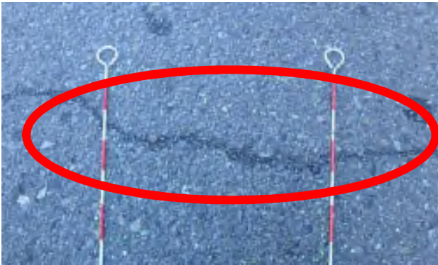
写真5 コンテナヤードの補修前
