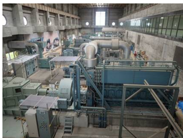
三郷外水機場のポンプ
