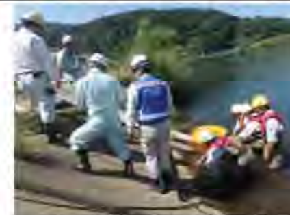
排水ポンプ車の設置・排水訓練
