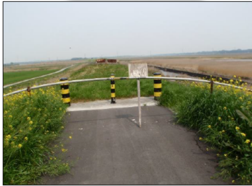
立入禁止看板の破損
