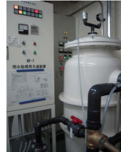
雨水利用設備
