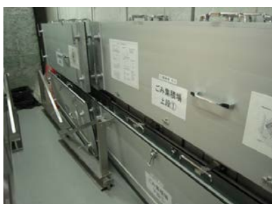
浸水対策として止水板の設置
