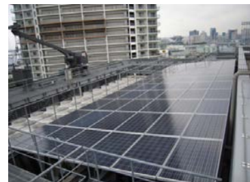
太陽光発電設備
