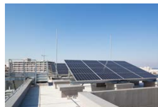
太陽光発電設備
