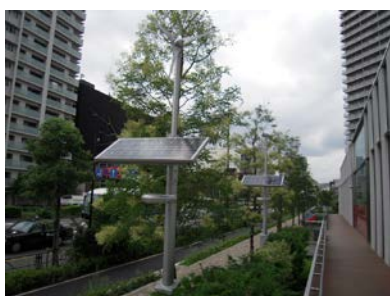
太陽光発電・風力発電を用いた屋外照明
