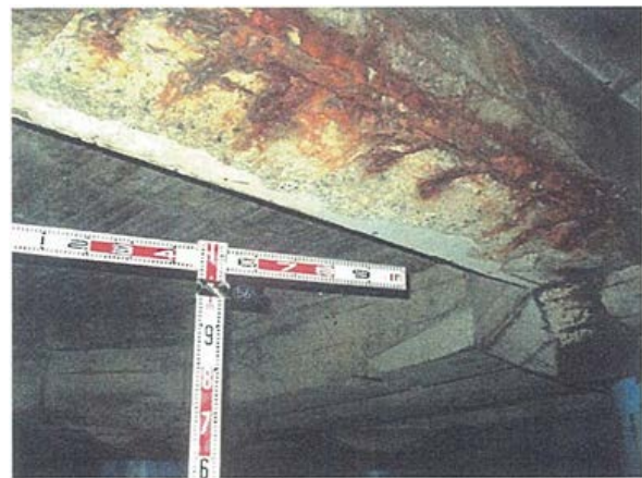
写真2 棧橋上部工梁部の鉄骨露出状況
