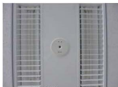
事務室天井に調光センサーを設置
