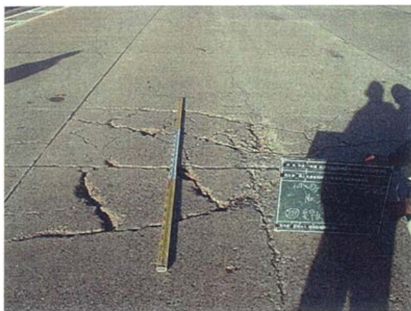
写真 1 エプロン舗装部のひび割れ状
