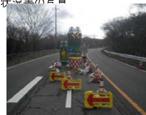
設置状況(昼間)
