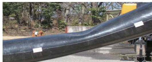
写真-4 高密度ポリエチレン管の変形状況
