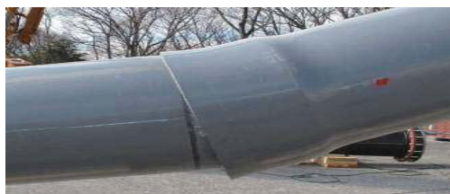
写真-6 硬質塩化ビニル管の変形状況
