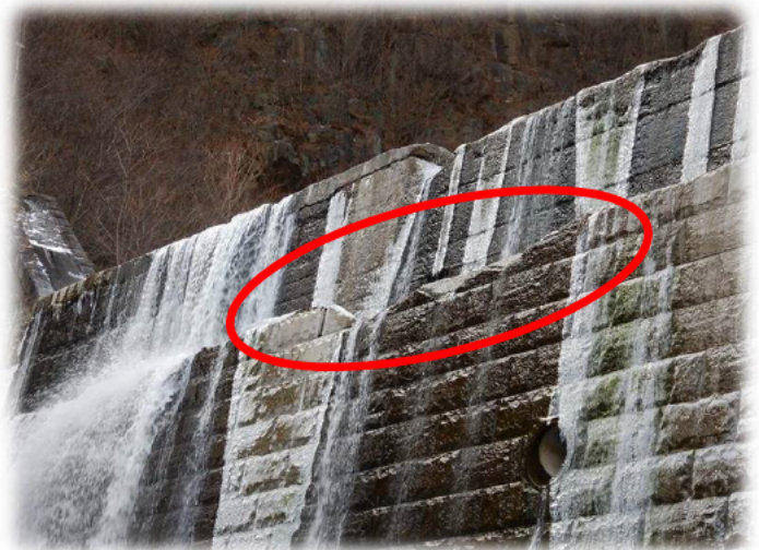
【12月13日撮影】 左の写真のアップです。 流水により、昨年施工した箇所が一部えぐられてしまいました。
