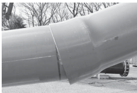
写真—6 硬質塩化ビニル管の変形状況
