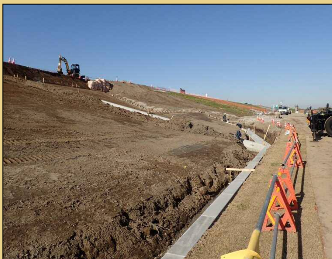
(川表側) これから堤防法面には、コンクリートブロックを設置する予定です。
