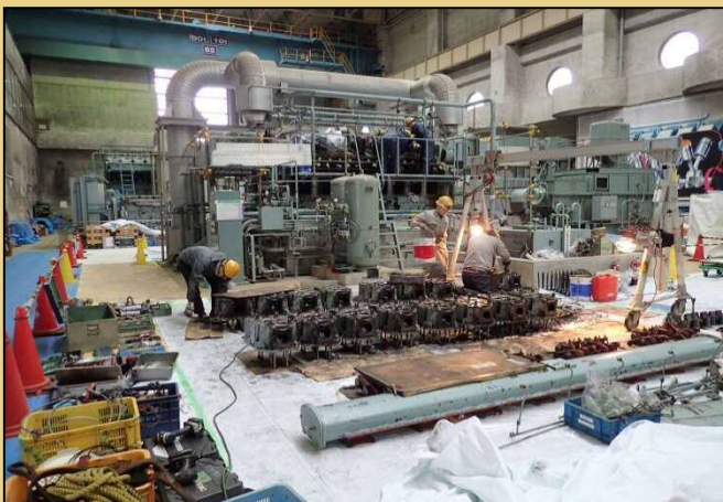
※主原動機(16気筒エンジン)の分解・整備を行っています。
