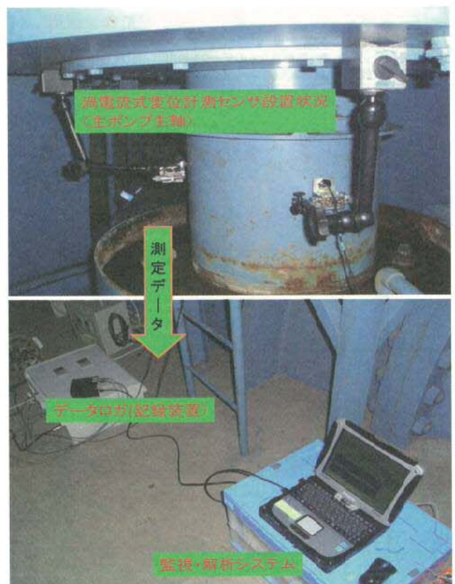
写-2 主ポンプ主軸露出部の振動計測状況
