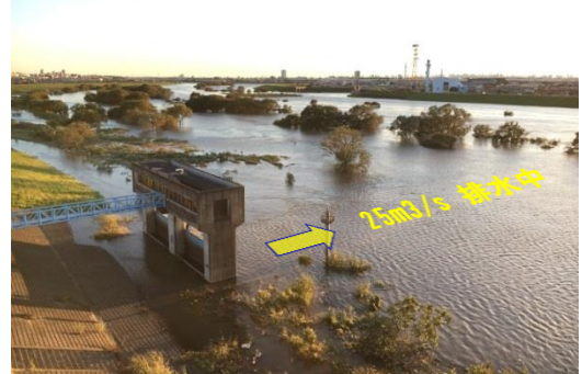
松戸排水機場1号機運転中
