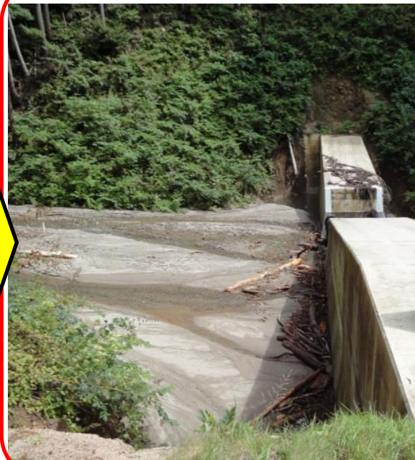
土石流発生直後 (H27.9.11)
