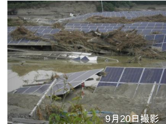
②溢水箇所(25.35k付近)被災状況
