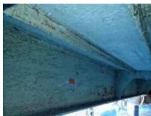
桁の塗装劣化やさびの発生
