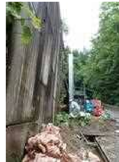
写真 壁面の傾斜の例
