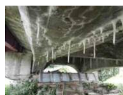
主桁のひびわれ
