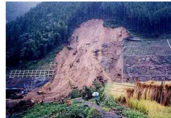
強風化・土砂化斜面での崩壊例
