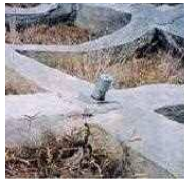
写真 受圧構造物の破損の例
