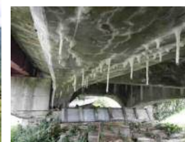
主桁のひびわれ
