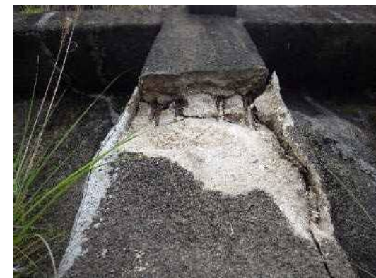
法枠工の老朽化損傷
