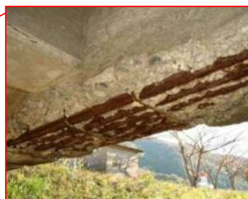
主桁の剥離、鉄筋露出
