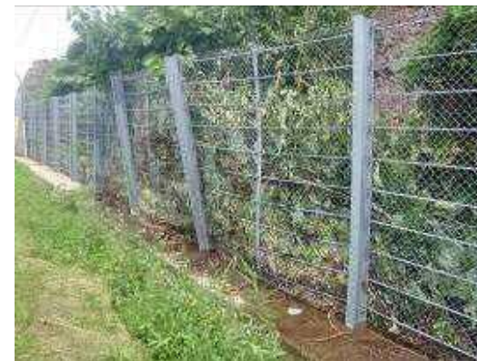
写真 落石防護柵の傾動の例
