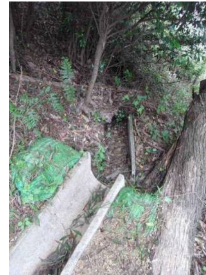
写真 排水溝の破損の例
