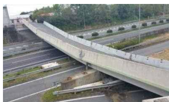
ロッキング橋脚を有する橋の落橋
