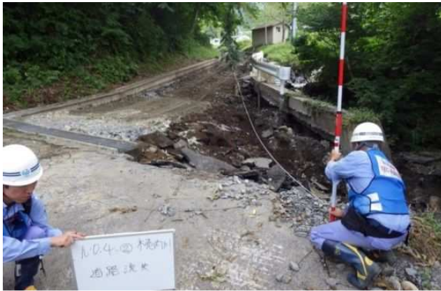
木売内川 被災状況調査(道路損壊)
