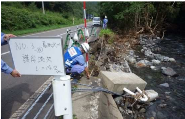
葛形沢川 被災状況調査(護岸洗掘)
