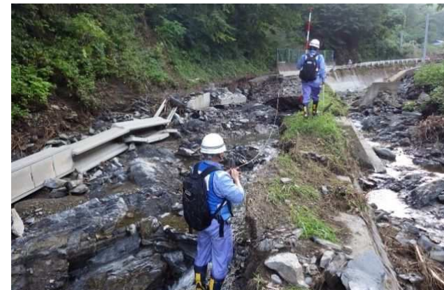
馬渡沢川 被災状況調査(護岸洗掘・道路崩壊)
