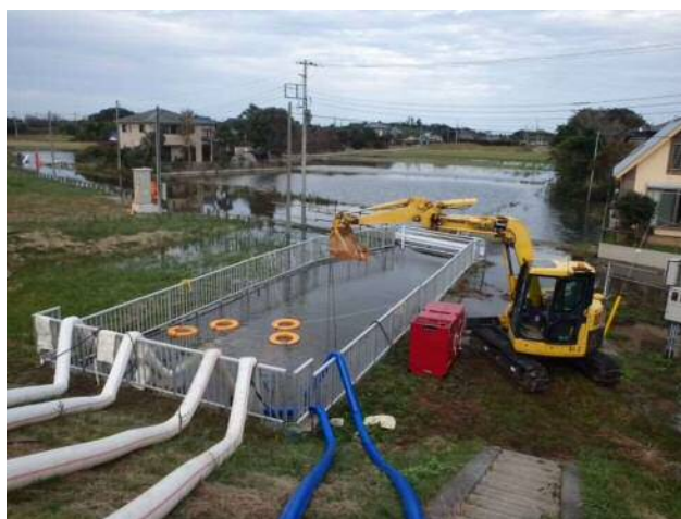
国土交通省排水ポンプ車による内水排除 (内水の状況)
