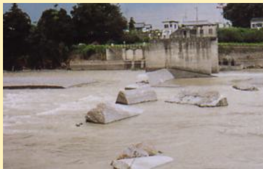
壊れてしまった六堰頭首工
