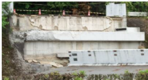
写真-2 横変位拘束構造の破壊、落橋（県道小川嘉島線・府領第一橋）
