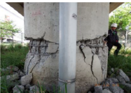
写真-7 段落し部の損傷
