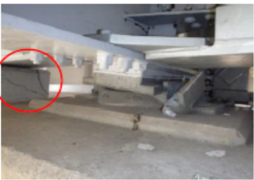
写真-6 支承の破損の状況
