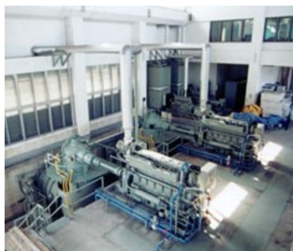
ポンプ室フロア
