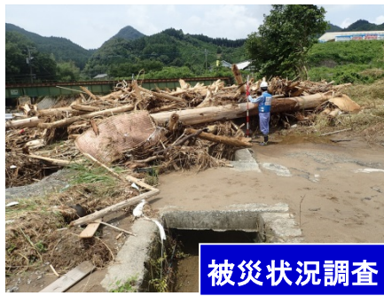
被災状況調査
