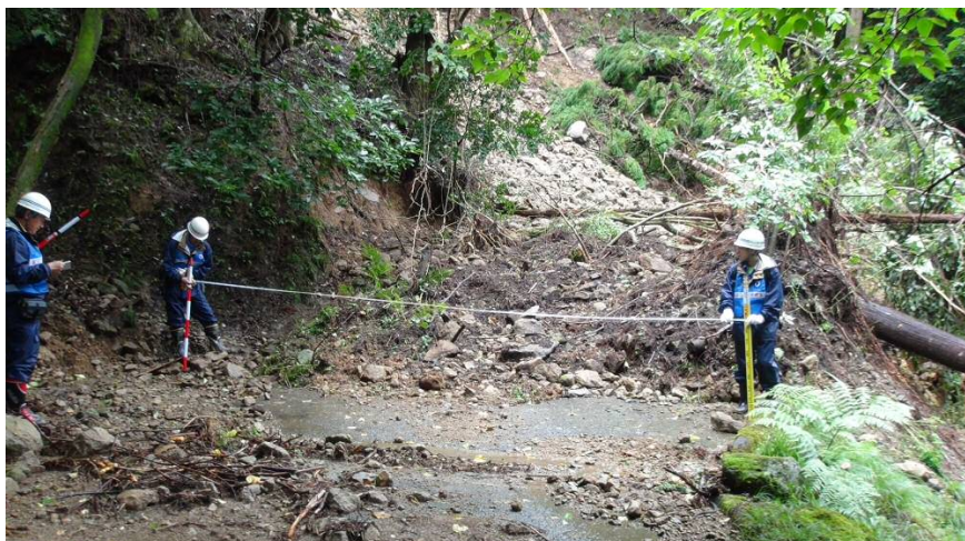
道路班：小石原地区にて林道の被災状況調査
