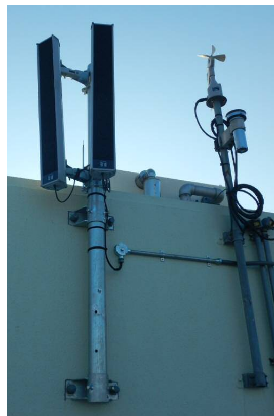
防災行政無線増設(江東区)
