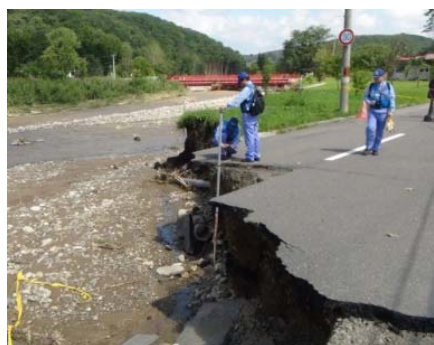
道路被害状況の調査
