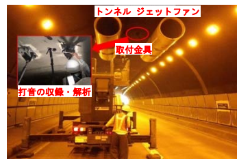
ジェットファン取付ボルト打音解析
