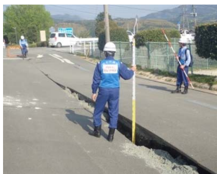
道路被害状況の調査
