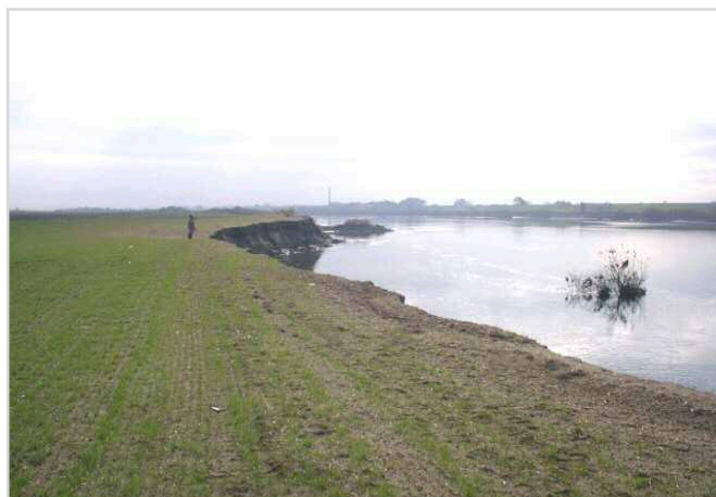
写真 6-1 河岸の侵食状況
