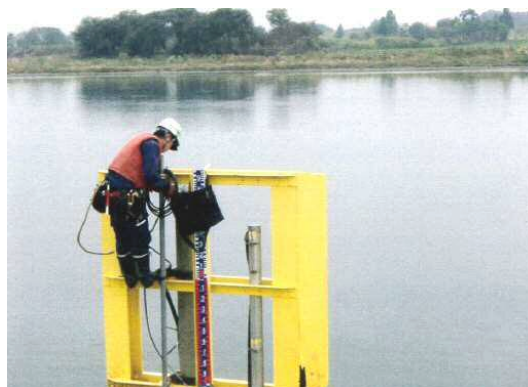
写真 5-6 水位計点検状況
