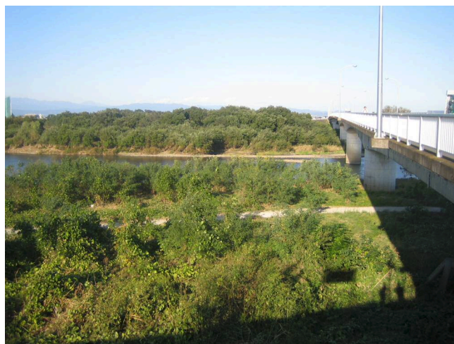
写真 3-3 河道内樹木繁茂状況
