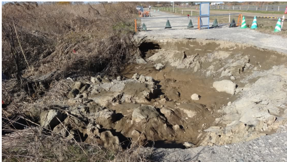
侵食状況（平成27年9月出水）
