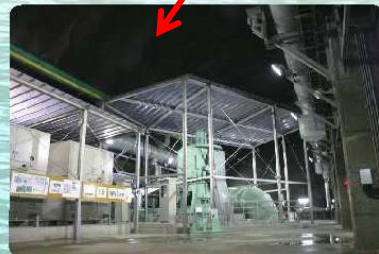
③ 導水ポンプ
