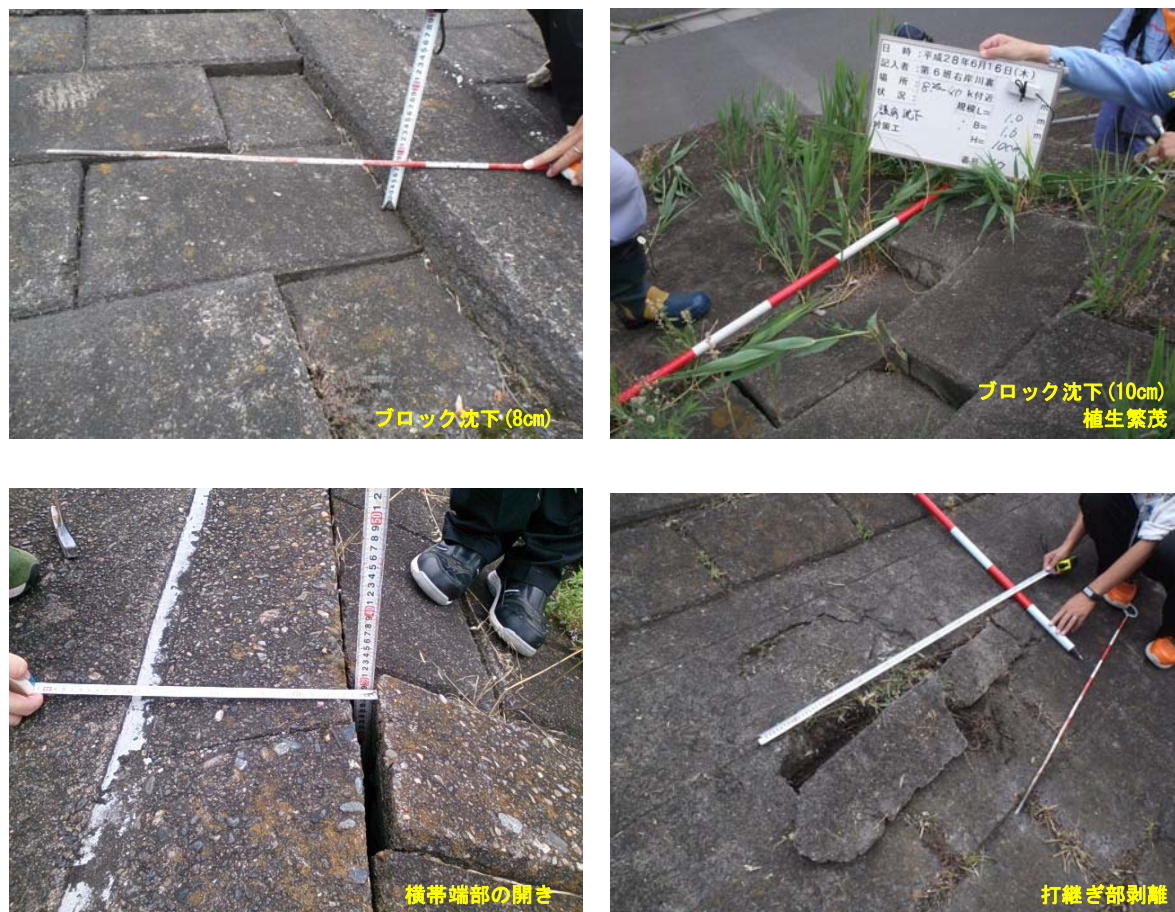
図 3-4 高潮堤防の老朽化の状況
