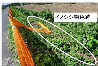
(2) 堤防法面の掘り返し被害
