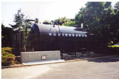
大規模災害時に飲料用を供給する 耐震性貯水槽
