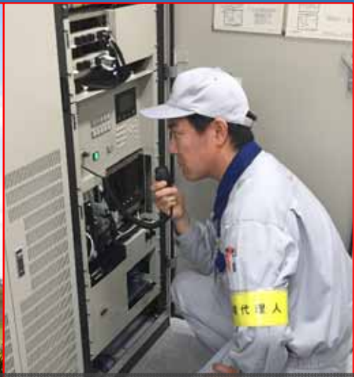
事務所の放送設備
