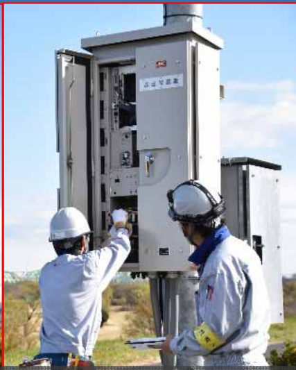
現場の放送設備
