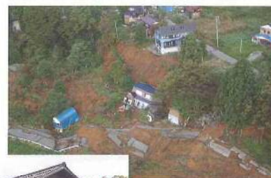
土砂くずれで すべり落ちた家屋や道路 （新潟県山古志村）
