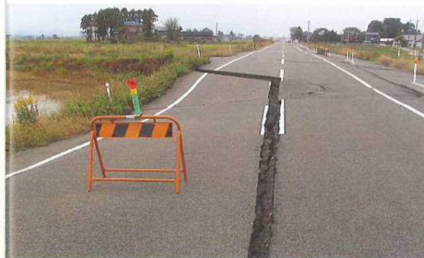
道路にひびが入り通行不能に（新潟県長岡市）
