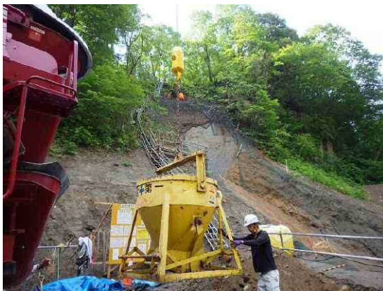
【写真-⑥】玉掛け警報機使用状況
