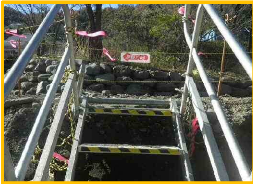
【写真－6】 歩行者通路に避難方向標示
