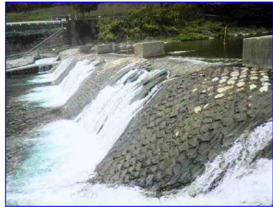
写真－２ 劣化状況（左岸より）
