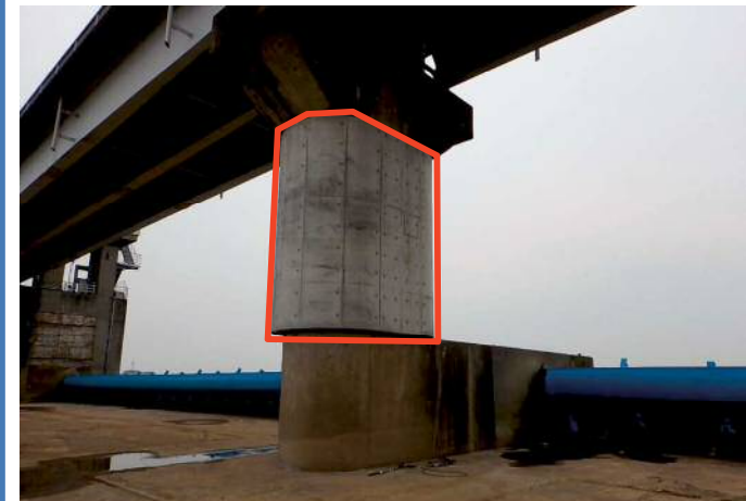
補強例(赤枠部を補強しています)
