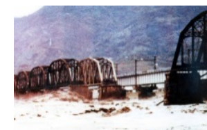
東海道本線鉄橋の流失
