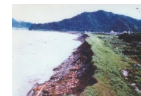
身延町波木井地先の堤防洗掘
