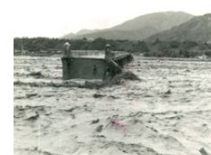
釜無川武田橋流失
