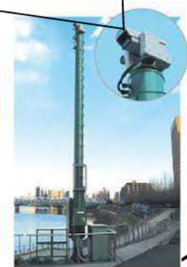
監視用カメラの増設
