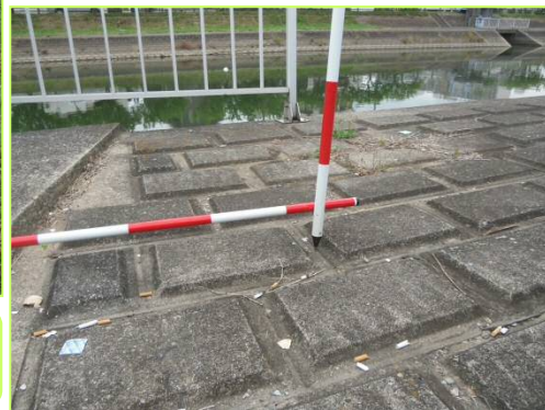
坂川左岸1.48k付近、川表小段の 平場沈下(高さ約0.07m)経過観察
