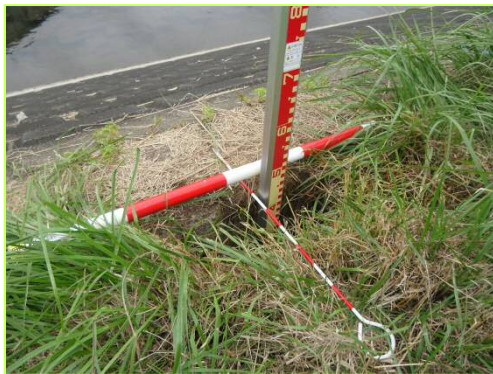
坂川左岸5.78k付近、高水護岸の 覆土陥没(深さ約0.40m)7月中補修
