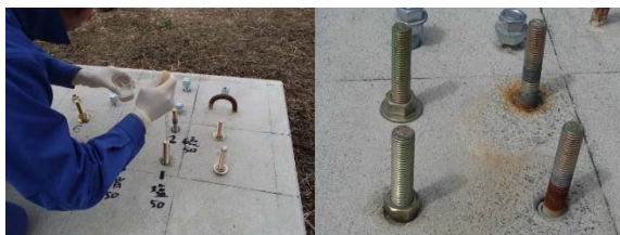
写真-5 アンカーボルトへの薬液による劣化状況
