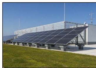
【屋上緑化・太陽光パネル】
