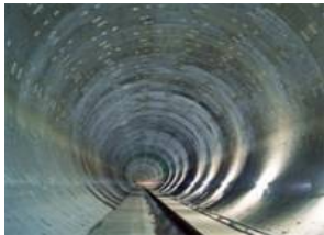
雨水貯留管 (和田弥生幹線 中野区・杉並区)
