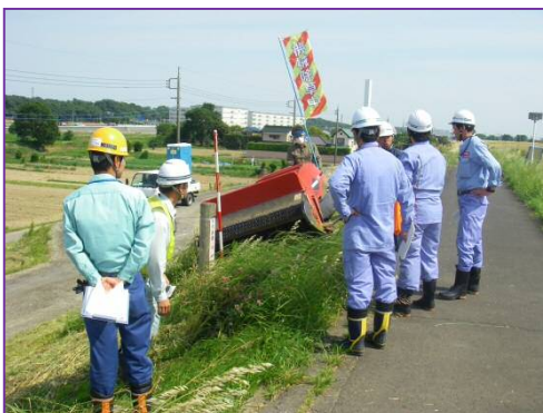
松戸管内河川維持工事における堤防除草作業状況の工事安全パトロール
