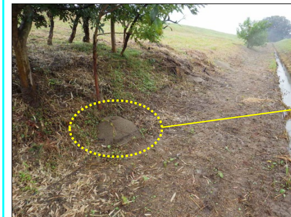
漏水(噴砂)箇所(H27/9/16撮影)
