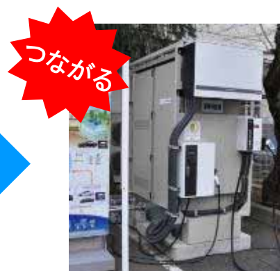
外部給電装置 (HEH55)
