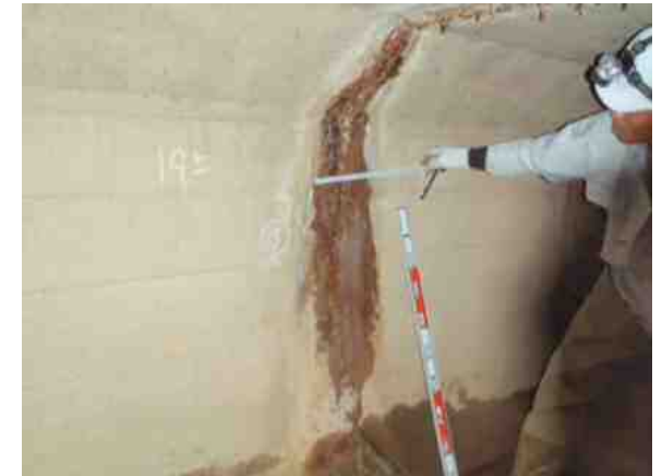
老朽化した樋管の状況
